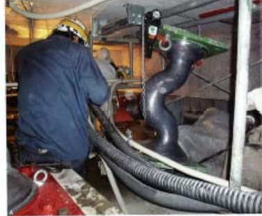
写真1-2 鉛ダンパーに亀裂が生じて交換
